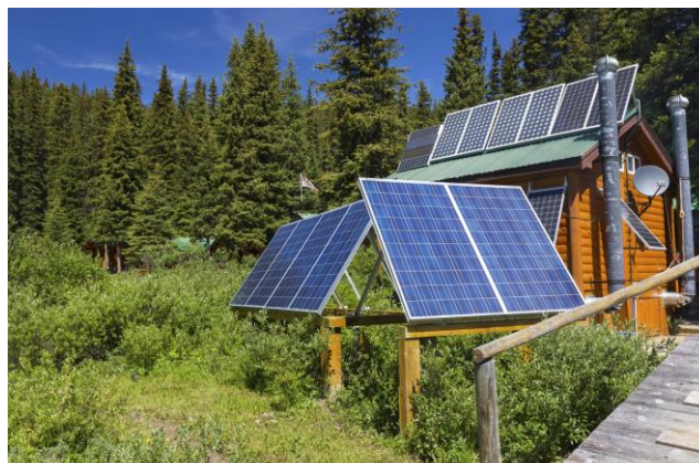
Panneaux solaires installés dans le parc national du Canada Banff
