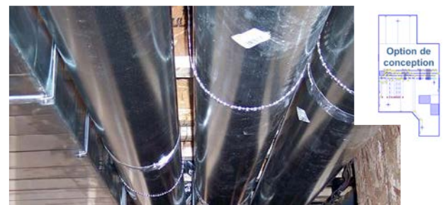
Figure 5-8 : Trois conduits d'alimentation ronds par zone; le conduit principal de retour est sur la gauche
