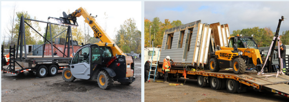
Figure 3-1 : (à gauche) chariot télescopique utilisé pour hisser un rack de stockage à ossature métallique sur une remorque en vue de sa livraison sur le chantier (à droite) chariot télescopique équipé d'une flèche hissant des racks sur une remorque à plateau en vue de leur transport.
