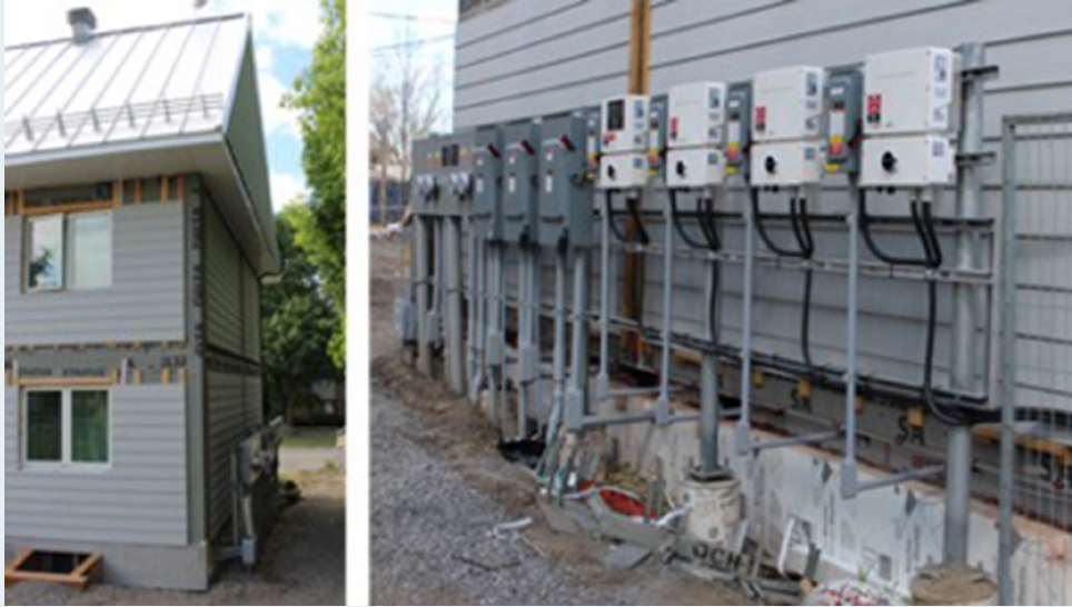
Figure 3-10 : L'infrastructure électrique du Logement communautaire d'Ottawa est montée sur des racks ancrés à des piliers suffisamment éloignés du bâtiment pour permettre l'installation de panneaux à l'arrière.
