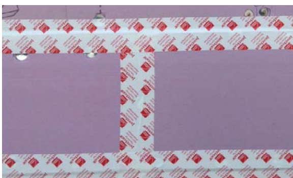
Figure 7 : Gros plan sur le système pare-air extérieur utilisant une isolation rigide en polystyrène extrudé avec des joints étanches, sur une maison de démonstration de Winnipeg, 2015. Référence photographique: Gary Proskiw
