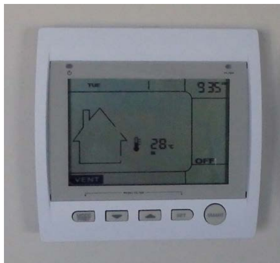
Figure 20 : Image d'un contrôleur avancé installé dans une maison d'essai LEEP. Référence photographique: Gio Robson
