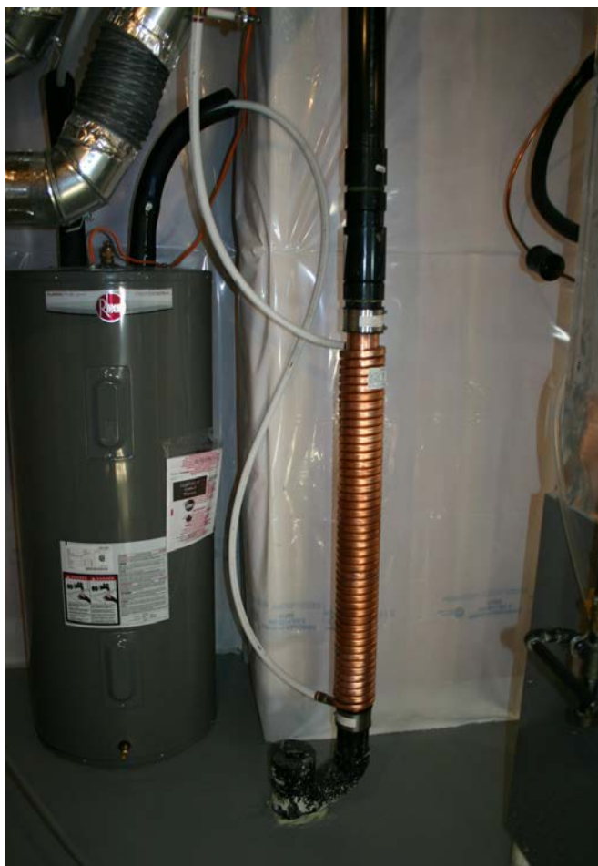
Figure 21 : Système de récupération de chaleur des eaux de drainage installé dans une maison d'essai LEEP. Référence photographique: Gio Robson
