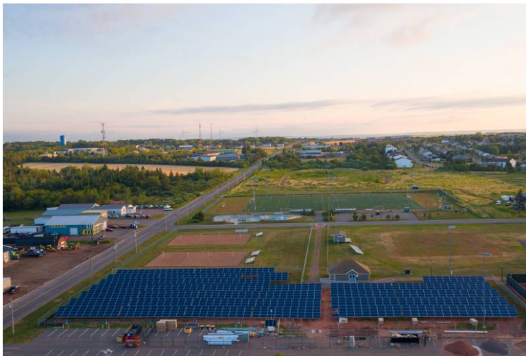
Figure 2 : Système de stockage solaire intelligent Credit Union Place avec un réseau de panneaux de 494 kW p à Summerside, dans l'Île-du-Prince-Édouard.
