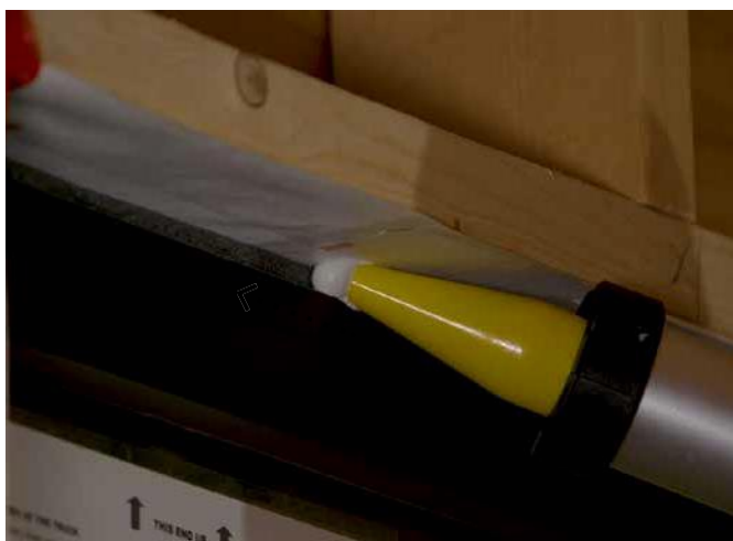
Figure 6 Exemple d'installation correcte et d'outillage simultané du mastic d'étanchéité à l'interface du périmètre de la fenêtre.
