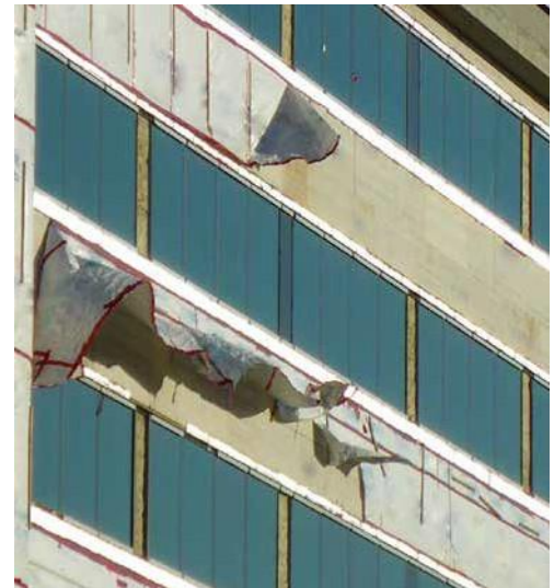
Figure 1 Dégâts causés par le vent à une membrane de revêtement mal collée pendant la construction.
