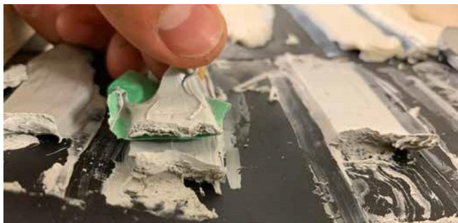
Figure 4 Exemple de rupture de cohésion du cordon d'étanchéité.
