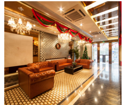
Figure 5. Éclairage intérieur - Hall d'hôtel
