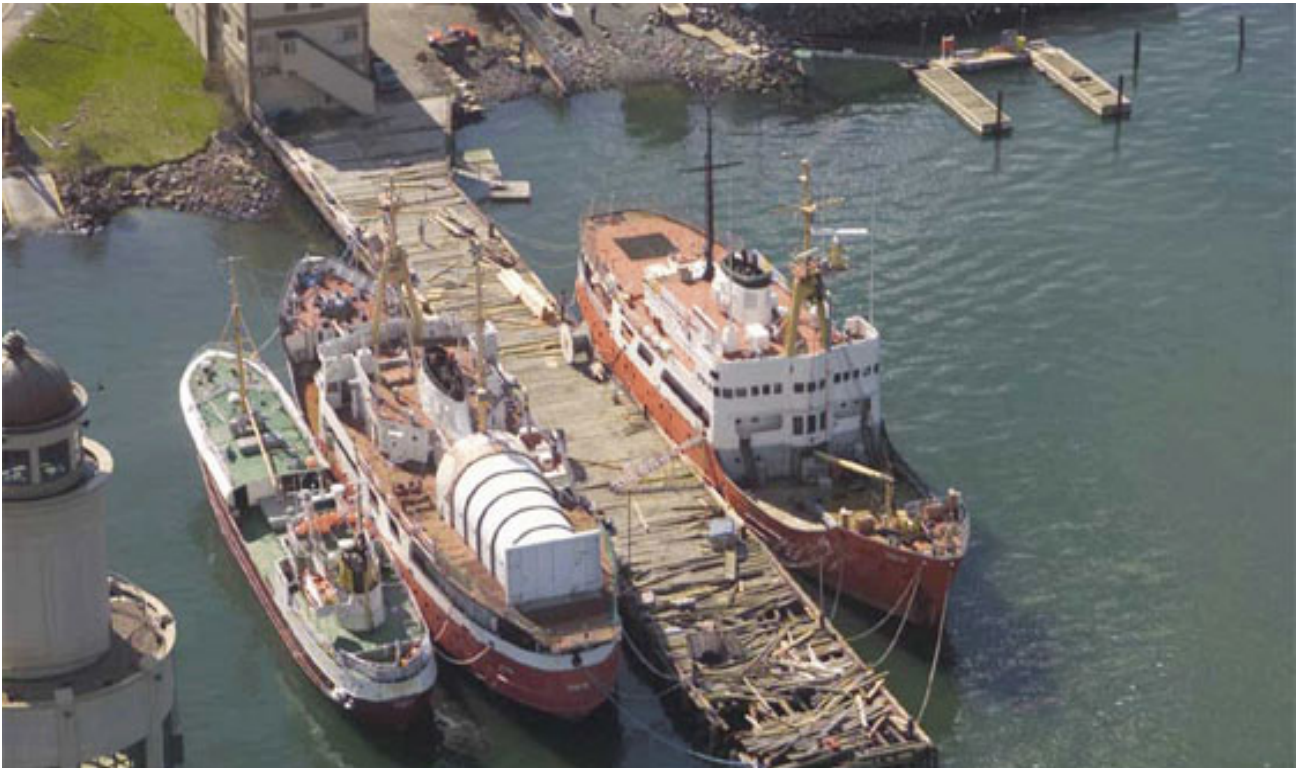
Figure 6 : Une onde de tempête provoque des dommages à un quai du port de Halifax. (Source : Environnement et Changement climatique Canada)
