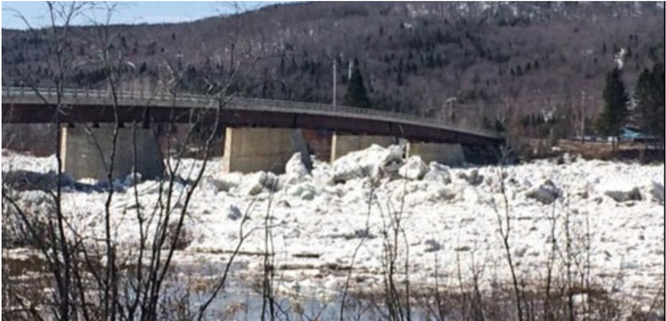
Figure 10 : Embâcle printanier sous un pont ferroviaire sur la rivière Saint-Jean. (Source : Société d'énergie du Nouveau-Brunswick)
