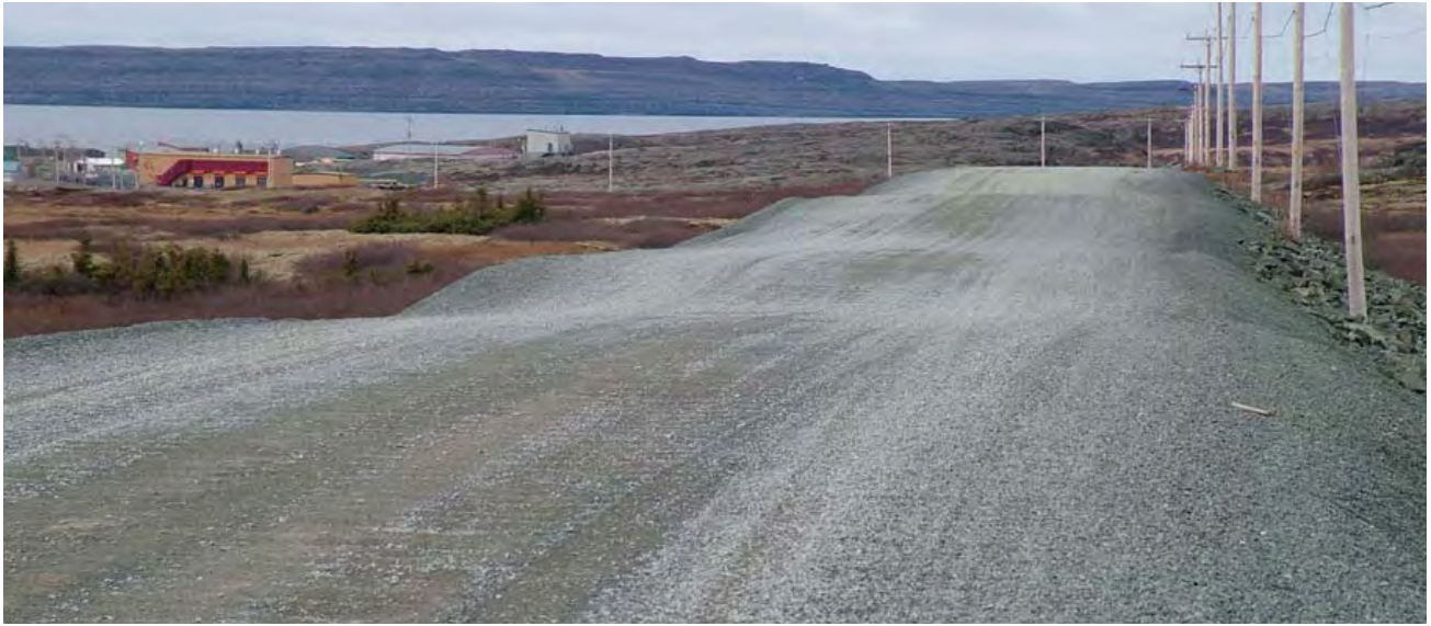
Figure 10 : Tassements importants sur la route d'accès, Umiujaq. (Source : Allard, M., Fortier, R., Sarrazin, D. et coll., 2007)
