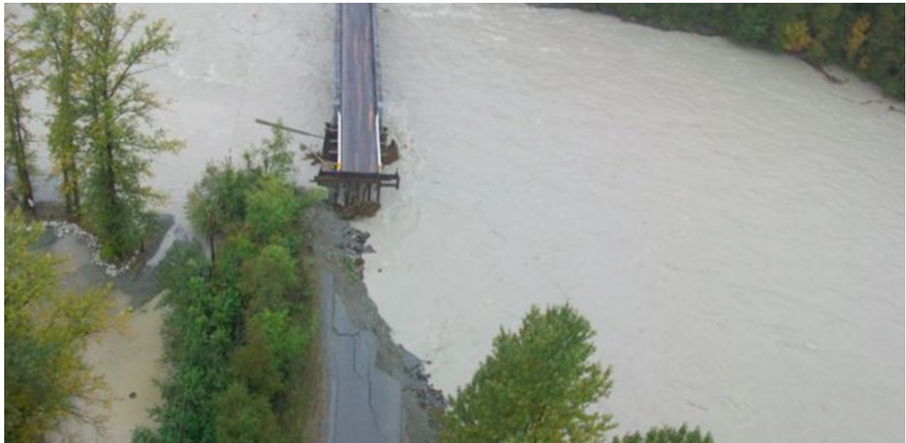
Figure 8 : Bella Coola – Répercussions des inondations sur la route 20 : Route Sallompt – Affouillement à l'approche du pont. (Source : Ministère des Transports et de l'Infrastructure de la Colombie-Britannique)
