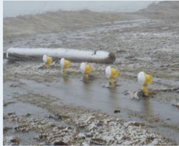
Figure 16 : La piste de Sandspit en décembre 2011. L'extrémité de la piste a été soumise à d'importants débordements de vagues pendant une violente tempête, alors que le niveau de la mer s'est élevé à environ un mètre au-dessus de la piste. Une section de 250 m du perré endommagé a dû être refaite.
