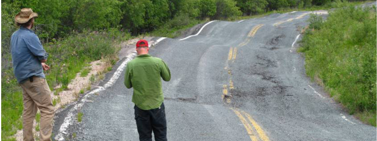
Figure 7: Tassement différentiel lié au dégel du pergélisol le long d'une section abandonnée de l'autoroute 4 dans les Territoires du Nord-Ouest, à l'est de Yellowknife. (Source : Ressources naturelles Canada)
