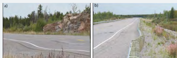
FIGURE 4 : Photographies de l'autoroute 3 illustrant a) la subsidence différentielle du revêtement et b) le déplacement de la glissière de sécurité provoqué par le glissement rotationnel des pentes latérales du remblai (Stevens et al. , 2012).
