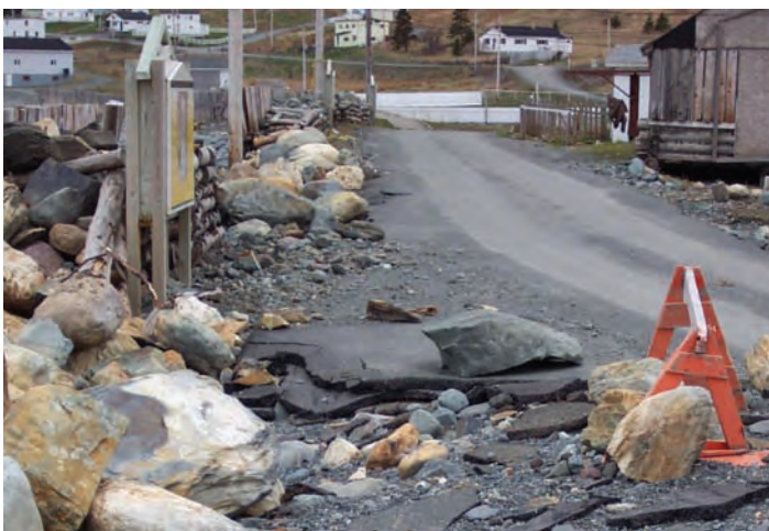
FIGURE 27 : Route endommagée par une onde de tempête en avril 2004, à Ferryland (Terre-Neuve-et-Labrador).
