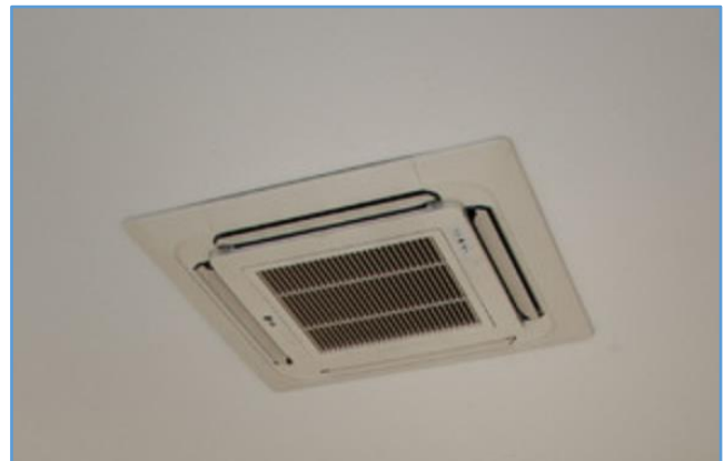
Figure 11 : Unité intérieure installée au plafond
