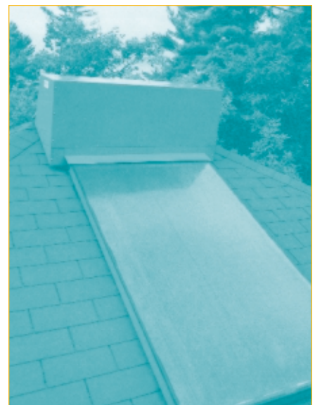
▲ Chauffe-eau solaire à thermosiphon à Camp Queen Elizabeth, île Beausoleil de la baie Georgienne, en Ontario. Gracieuseté de Solcan Ltd.
