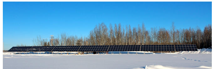
Figure 2: Fort Simpson est la plus grande communauté de la Northwest Territories Power Corporation alimentée au diesel. Ce système de 61 kilowatts (le plus gros système PV au Canada au nord du 60e parallèle) diminuera la consommation de combustible de 15 000 litres annuellement et fournira jusqu'à 8.5% du besoin minimal du village pendant l'été. (Photo: Skyfire Energy)
