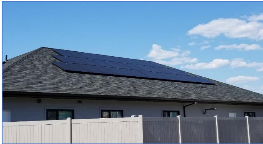
Figure 21 : Système prévu pour une puissance de 15 kWc, limité à 10 kWc par le panneau de service électrique choisi - avec l'aimable autorisation de Riverside Energy Systems
