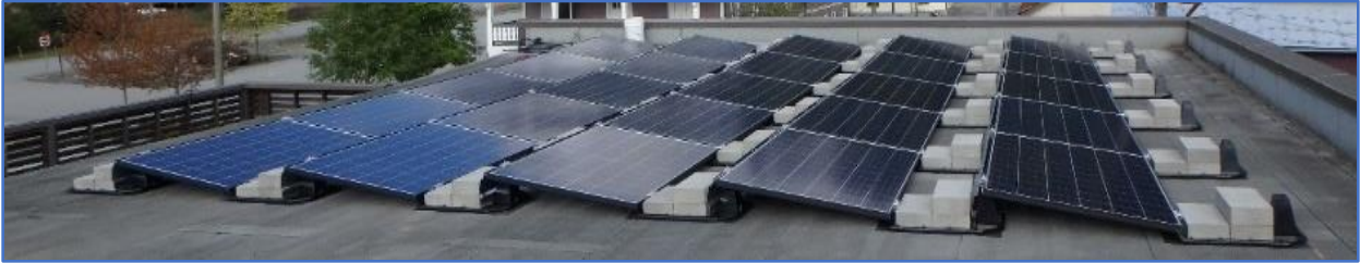
Figure 25 : Exemple de champ de panneaux solaires PV sur un toit-terrasse ballasté – avec l'aimable autorisation de Riverside Energy Systems
