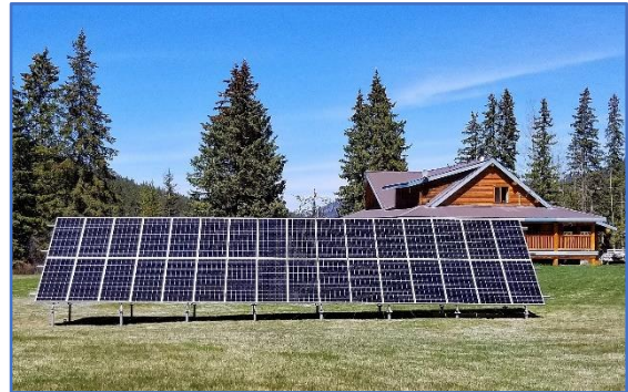
Figure 17 : Champ de panneaux solaires PV à installation au sol - avec l'aimable autorisation de Riverside Energy Systems
