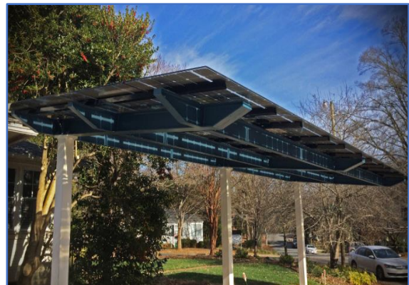
Figure 15 : Abri solaire PV résidentiel pour place de stationnement – avec l'aimable autorisation de Lumos Solar
